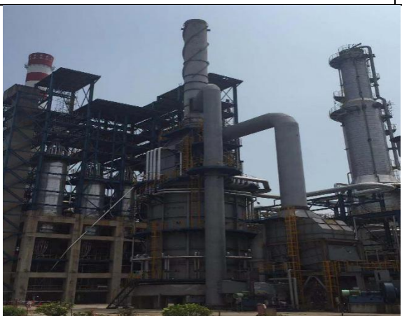
催化重整装置稳定塔重沸炉
