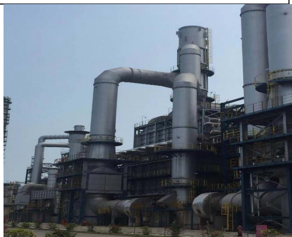
吸附分离装置 1 二甲苯分馏塔重沸炉
