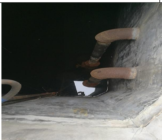
事故水提升泵及提升管
