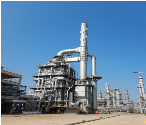
凝析油加氢装置进料加热炉
