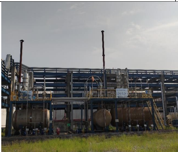
罐区脱臭设施
