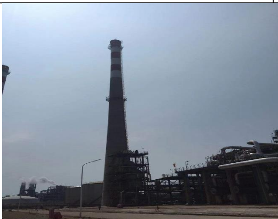
硫磺回收装置尾气焚烧炉
