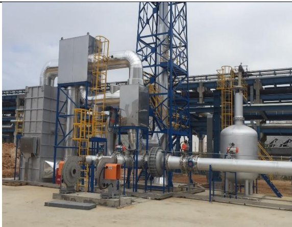
“三苯”储罐废气设施
