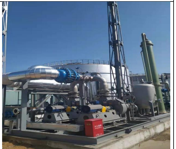
污水处理场脱臭设施
