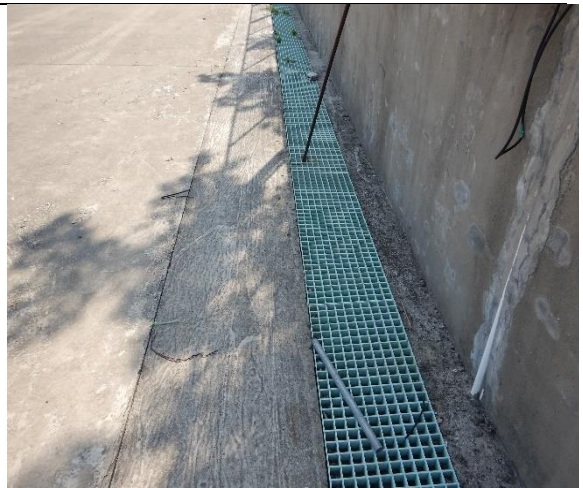
暂存间外的收集沟
