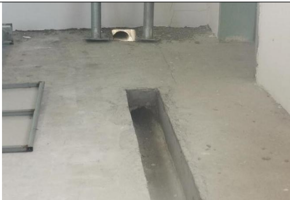
固废仓库内部导流沟
